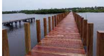
Maquette de la passerelle et Image de la passerelle de Mèko en cours de construction
